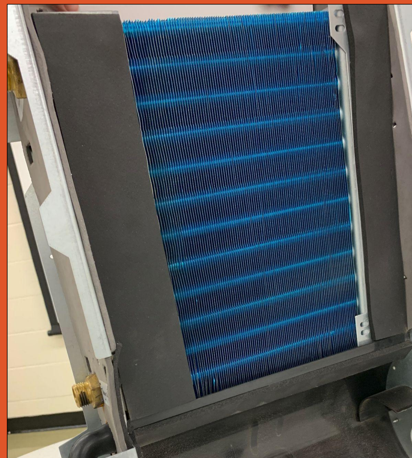
Existing fan coil unit
